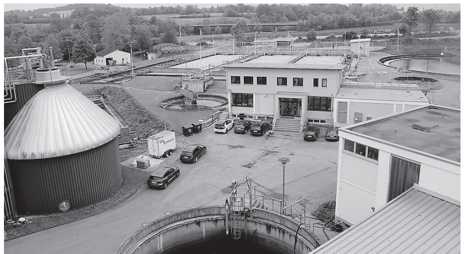
Das Crailsheimer Klärwerk profitiert von einer Mittelumschichtung für ein Vorklärbecken. Foto: Stadtverwaltung
